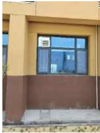
陆上升压站排烟口
