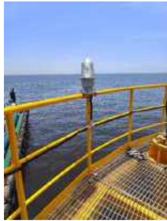
风机套笼通航警示灯
