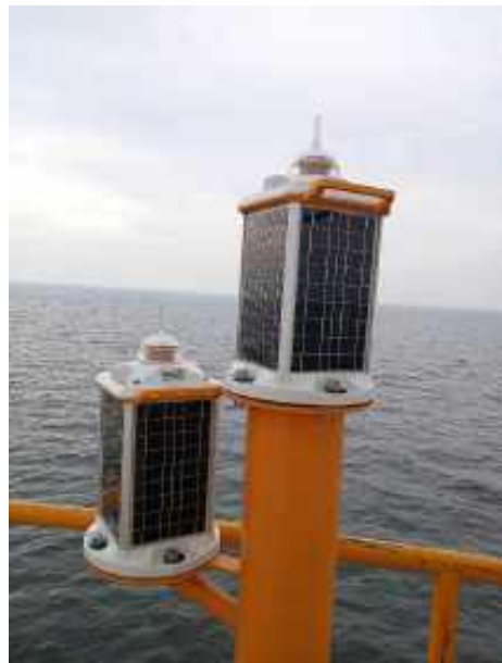
风机警示灯桩
